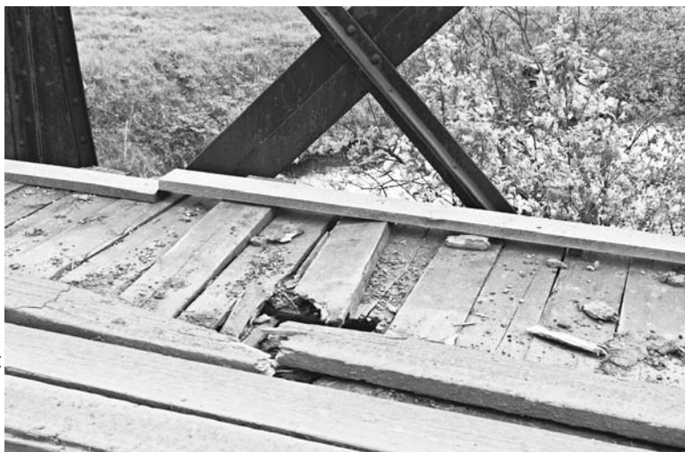
Доски на мосту не выдерживают нагрузки, ломаются и крошатся
