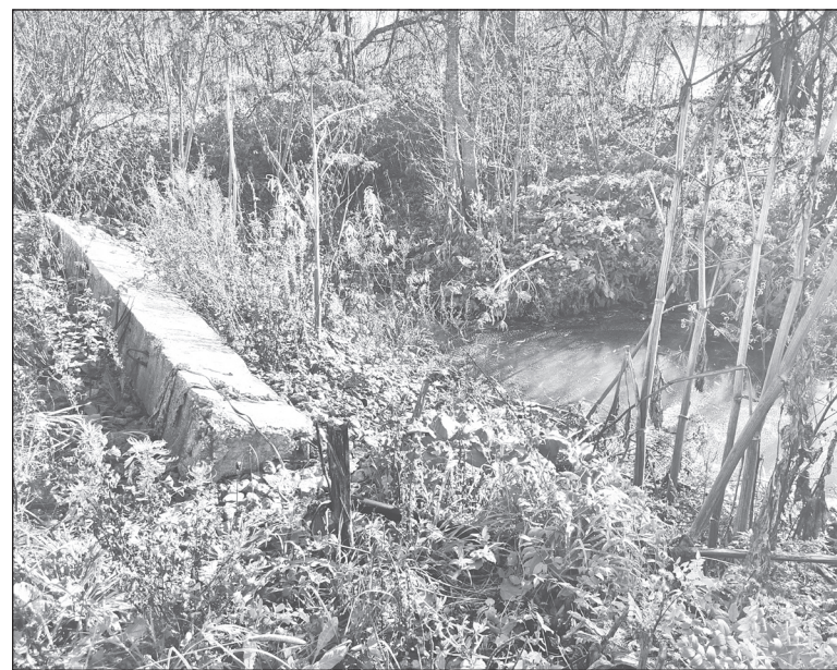
Деревенские жители сомневаются, что пожарные смогут (в случае острой необходимости) пополнить запасы воды из этой «лужицы».
