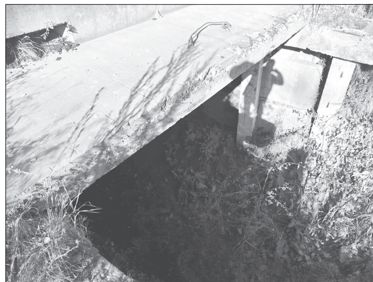
Состояние моста через реку Каменку вызывает у местных жителей тревогу и опасения.
