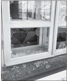
Разбиты стёкла в здании музея, в котором ведётся ремонт.
