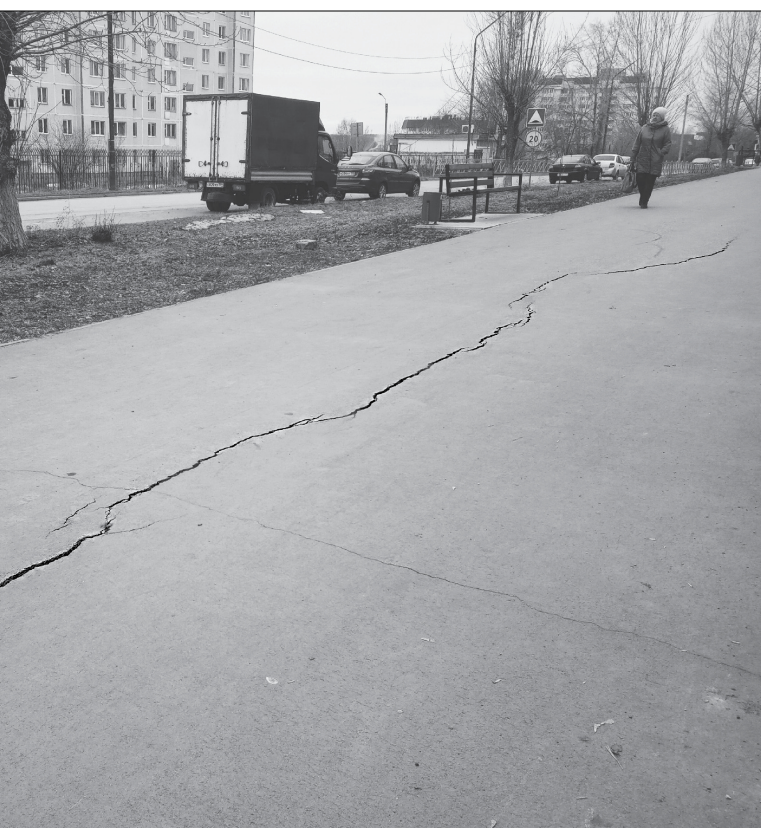
📷 Вдоль нового тротуара по ул. Энгельса в Добрянке протянулась огромная трещина. / ФОТО В. САЗОНОВОЙ
