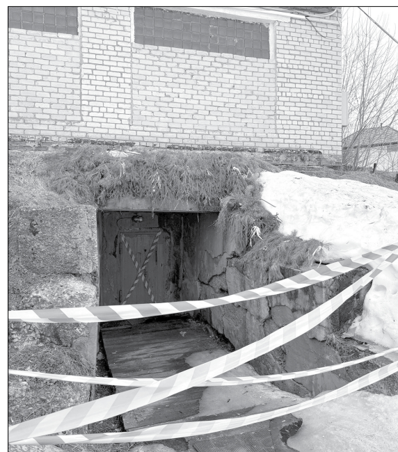
📷 Разрушающиеся конструкции здания Дома спорта в Полазне огорожены сигнальными лентами. / ФОТО ТАТЬЯНЫ КТЧЕКОВОЙ
