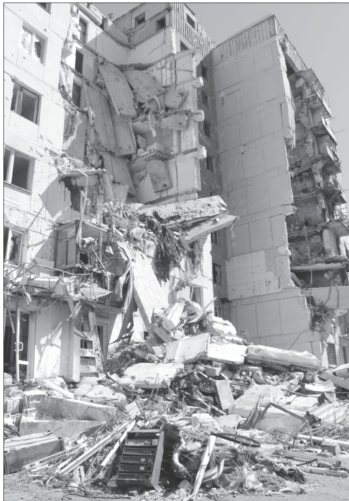
Город Рубжное сильно пострадал в по время боёв. Но в нём уже побывали специалисты-строители, осмотревшие строения на предмет их восстановления или сноса. / ФОТО АВТОРА
