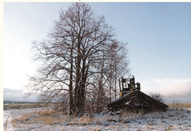
На фото: В настоящее время часовня находится вот в таком состоянии.
