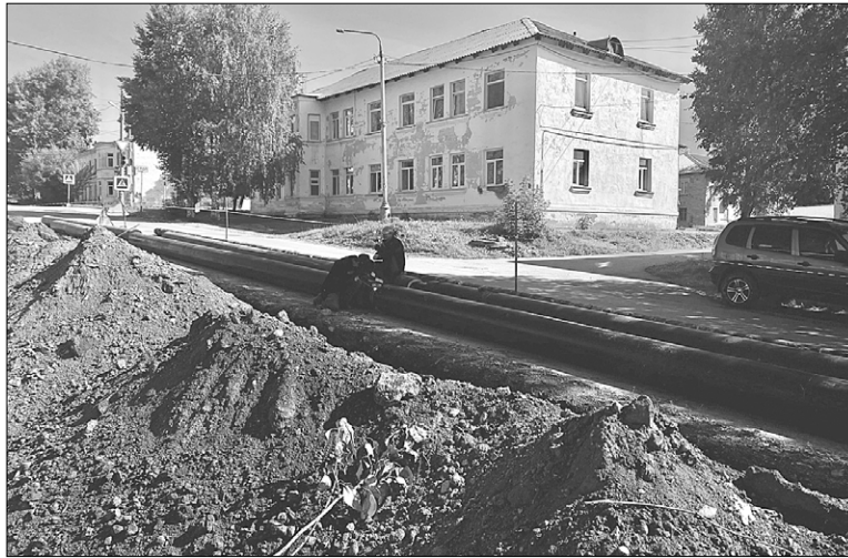
❖ Город очень ждёт реконструкцию системы теплоснабжения.
