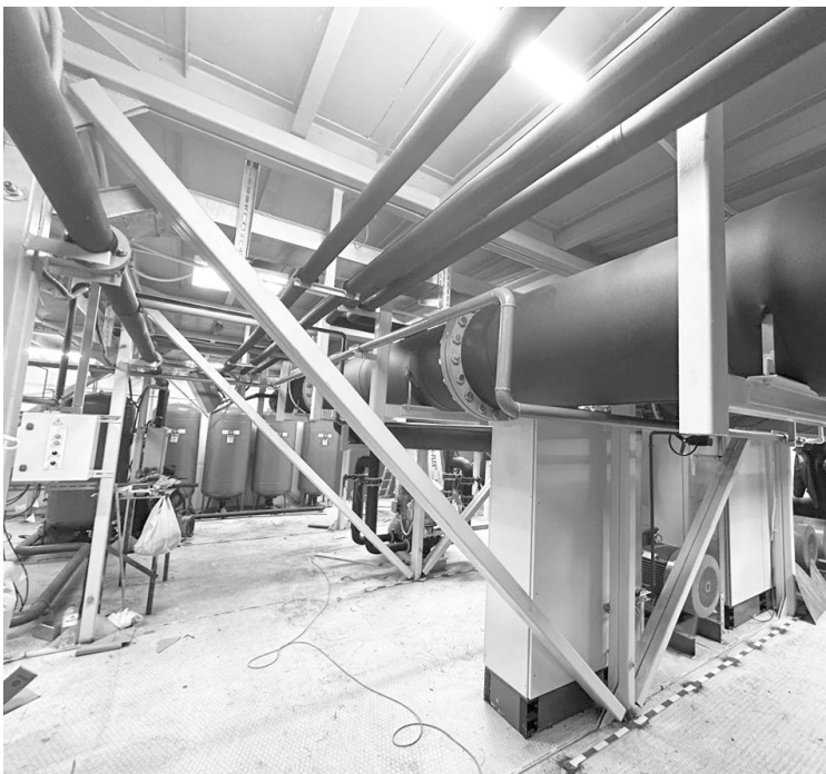
Новая котельная внутри
