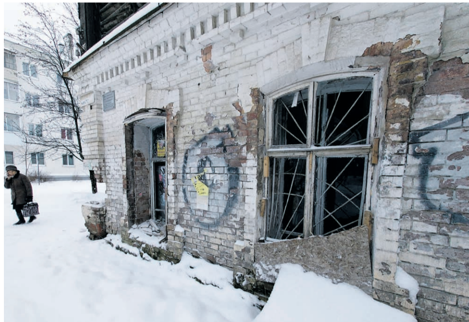
Старые здания становятся опасными. / ФОТО: АНДРЕЙ КУДРИН, «ИСКРА»
