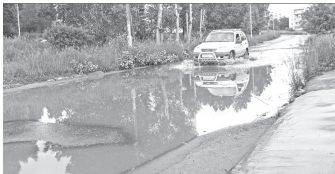
Долгие годы на дороге по ул. Энергетиков в Добрянке стояла огромная лужа. / ФОТО ИЗ АРХИВА РЕДАКЦИИ
