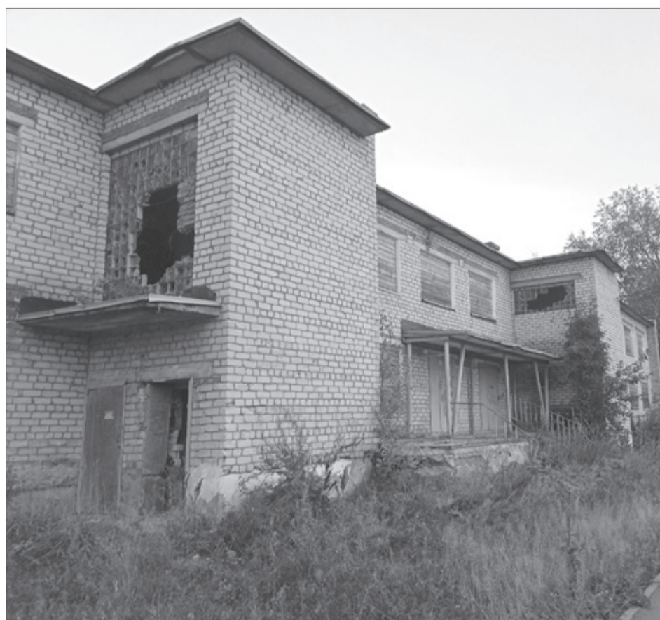
Пустующее здание интерната ветшает и разрушается. / ФОТО КСЕНИИ БЛАЖИЕВСКОЙ
