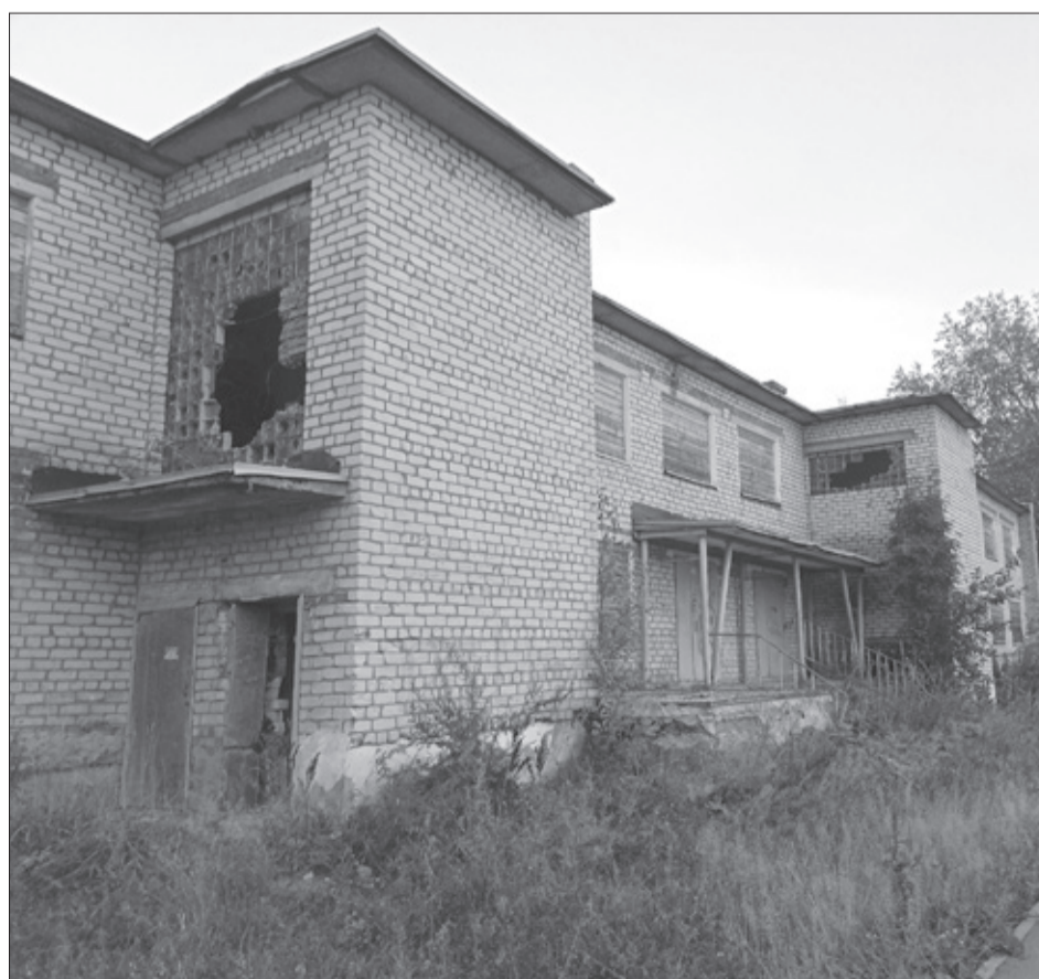
Пустующее здание интерната ветшает и разрушается. / ФОТО КСЕНИЯ БЛАЖИЕВСКОЙ
