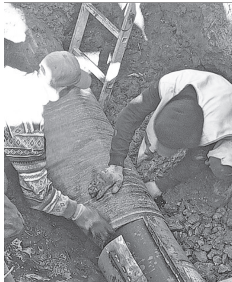
Работники МБУ «Благоустройство» в начале сентября отремонтировали ливневую канализацию на участке ул. Энергетиков.
